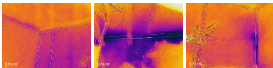
Figura 2. Termografías de las infiltraciones en la unión entre el suelo y los paneles de esquina durante el ensayo de blower-door
